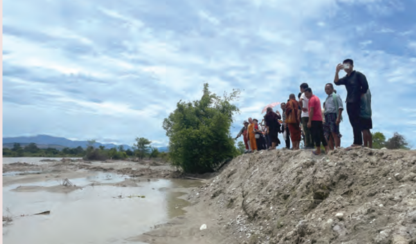
사진 2. 홍수로 제방이 붕괴된 비자이뿌르 마을을 둘러보는 봉사단 일행. 유실된 강둑에 모래를 쌓아 임시 제방을 쌓아 놓은 상태다.
